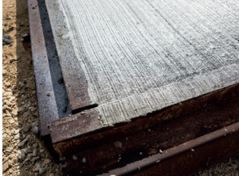
Bild 4: Betonoberfläche an der Randabschalung
